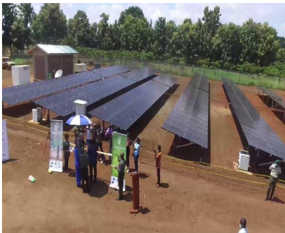
Centrale solaire construit à Faradje
